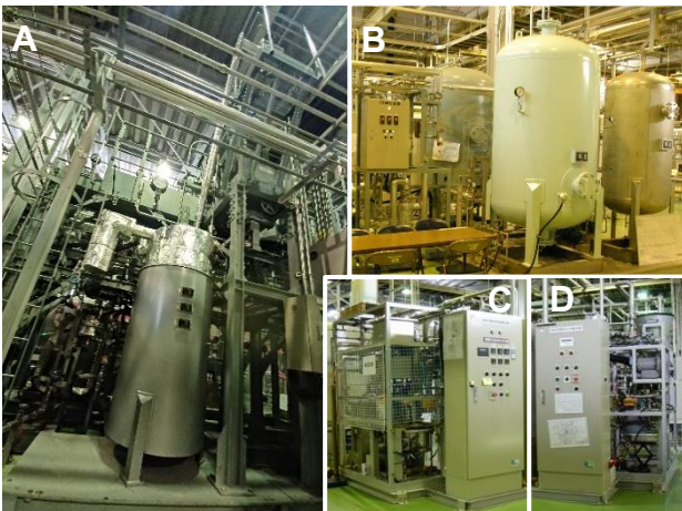
図 7 CEEF_閉鎖系植物実験施設の廃棄物処理設備（A: 湿式酸化装置, B: 廃棄物処理排ガス処理設備, C: 炭化処理装置, D: 燃焼処理装置）と窒素固定設備（E: N_2 と水からアンモニアと硝酸合成）
