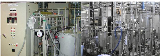
図 6 CEEF_閉鎖系植物実験施設_養液処理・調整設備（左: 肥料廃水処理装置（RO（逆浸透）膜使用）、右: 養液調整装置（廃棄物湿式酸化分解溶液、窒素固定設備で作製したアンモニア水及び硝酸水、または濃縮養液、各ミネラル成分溶液（EDTA 鉄溶液等）などから凝縮水・回収水を用いて作物栽培養液を調合、pH 調整し各栽培床へ順次送液）
