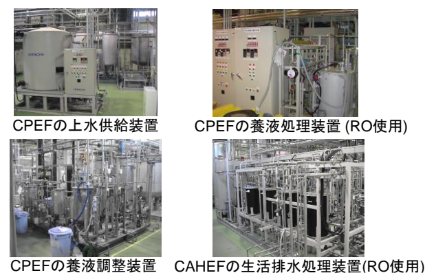
図8 閉鎖居住実験で用いた水処理システム
