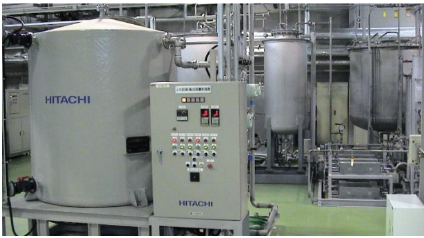
図 5 CEEF_閉鎖系植物実験施設_水処理設備（前左: 上水槽（空調凝縮水受入れ）、後: 中水槽（廃養液からの回収水受入れ）、右後: 肥料用水槽（養液調合用浄化水タンク）、右下: 紫外線殺菌装置）
