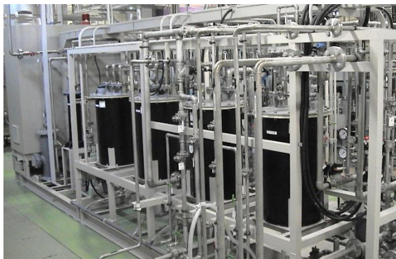
図 10 CEEF_閉鎖系動物飼育・居住実験施設_排水処理設備 (RO (逆浸透) 膜使用)
