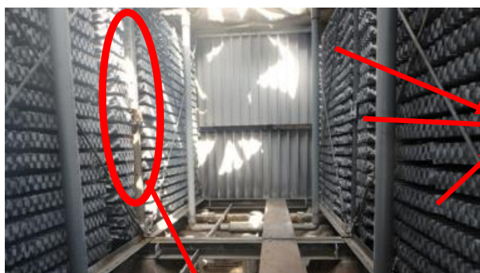
第1 研究棟 冷却塔内部（点検口から）
