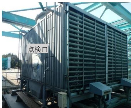
第1 研究棟冷却塔
