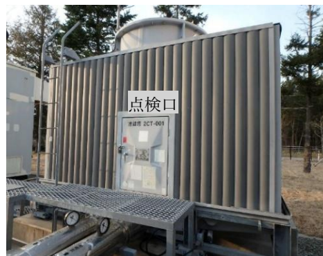
第2 研究棟冷却塔
