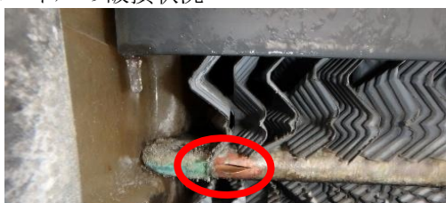
冷却コイルの破損状況
